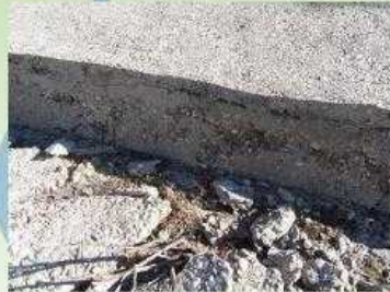
Zapata-Plinto de apoyo de pantalla con patologías en el hormigón
