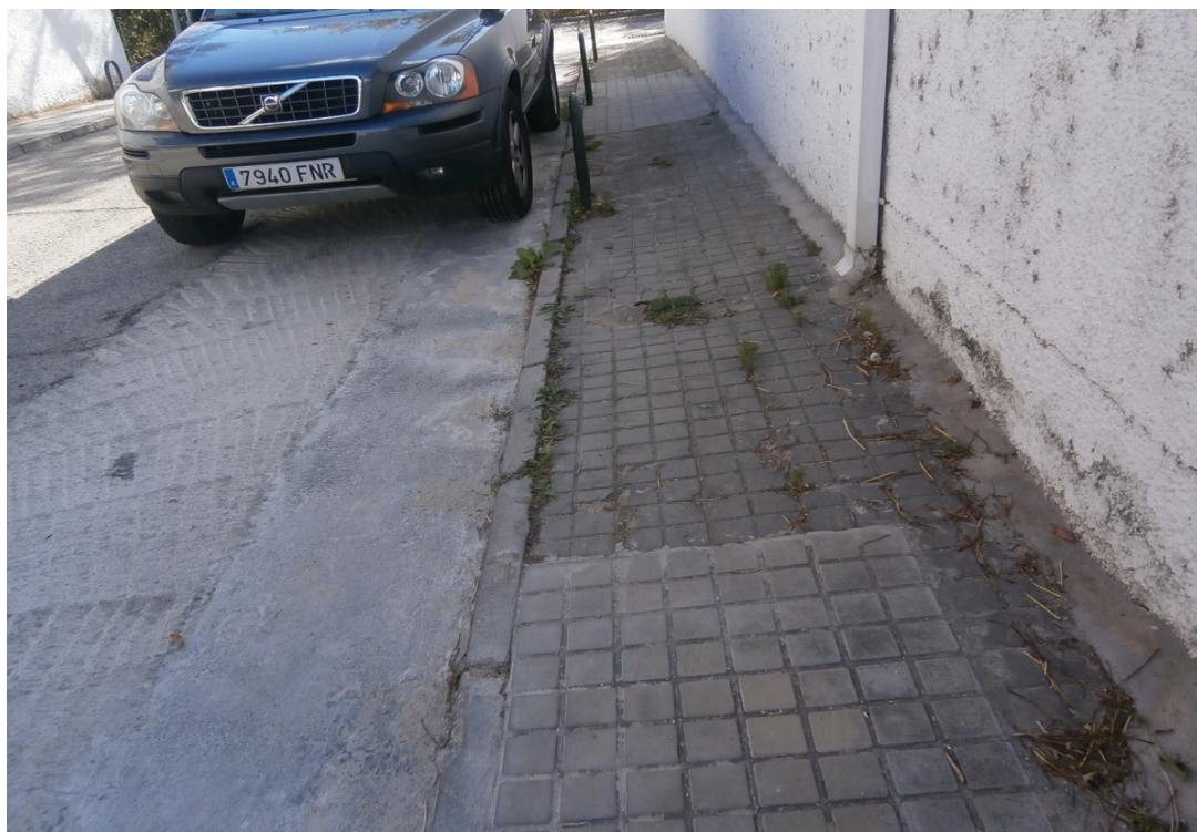
FOTO N° 10. Acera y bordillo con roturas. Hundimiento de acera. (MD-Fase 1).
