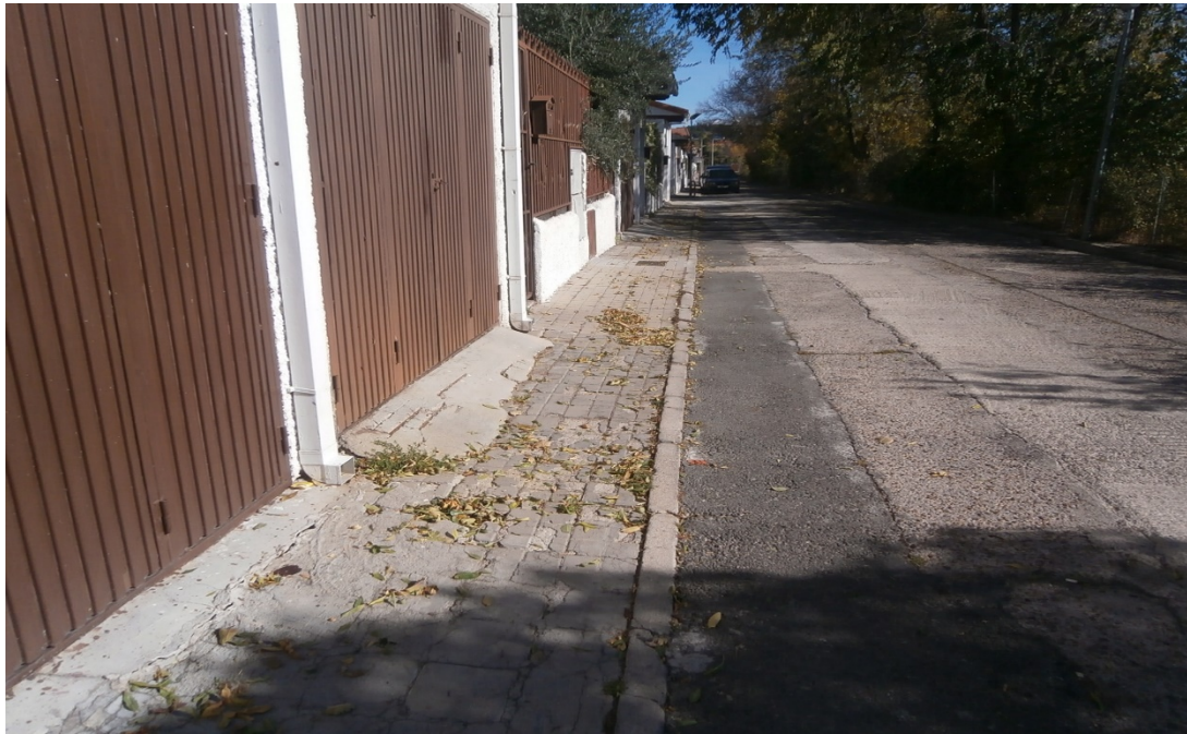
FOTO N° 11. Acera y bordillo con roturas. Firme fisurado a lo largo de toda la calle. (MD-Fase 1).
