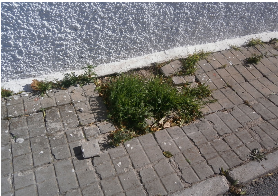
FOTO N° 10. Acera y bordillo con roturas. (MI-Fase 1).
