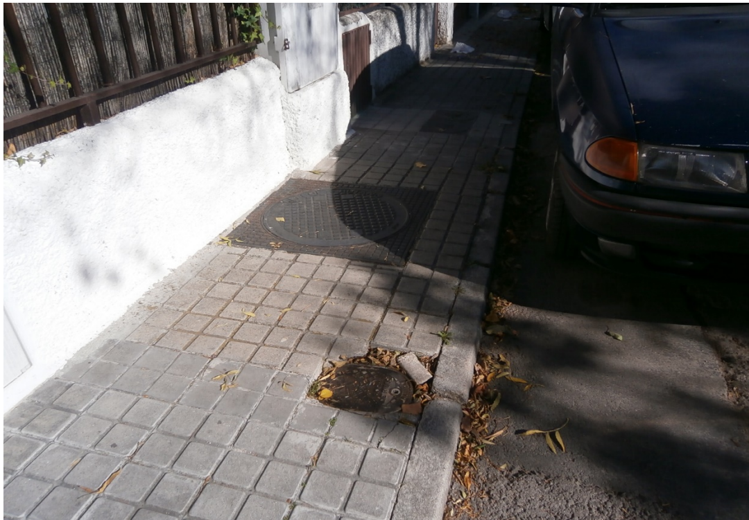
FOTO N° 6. Rotura de acera. Boca de riego. (MD-Fase 2).
