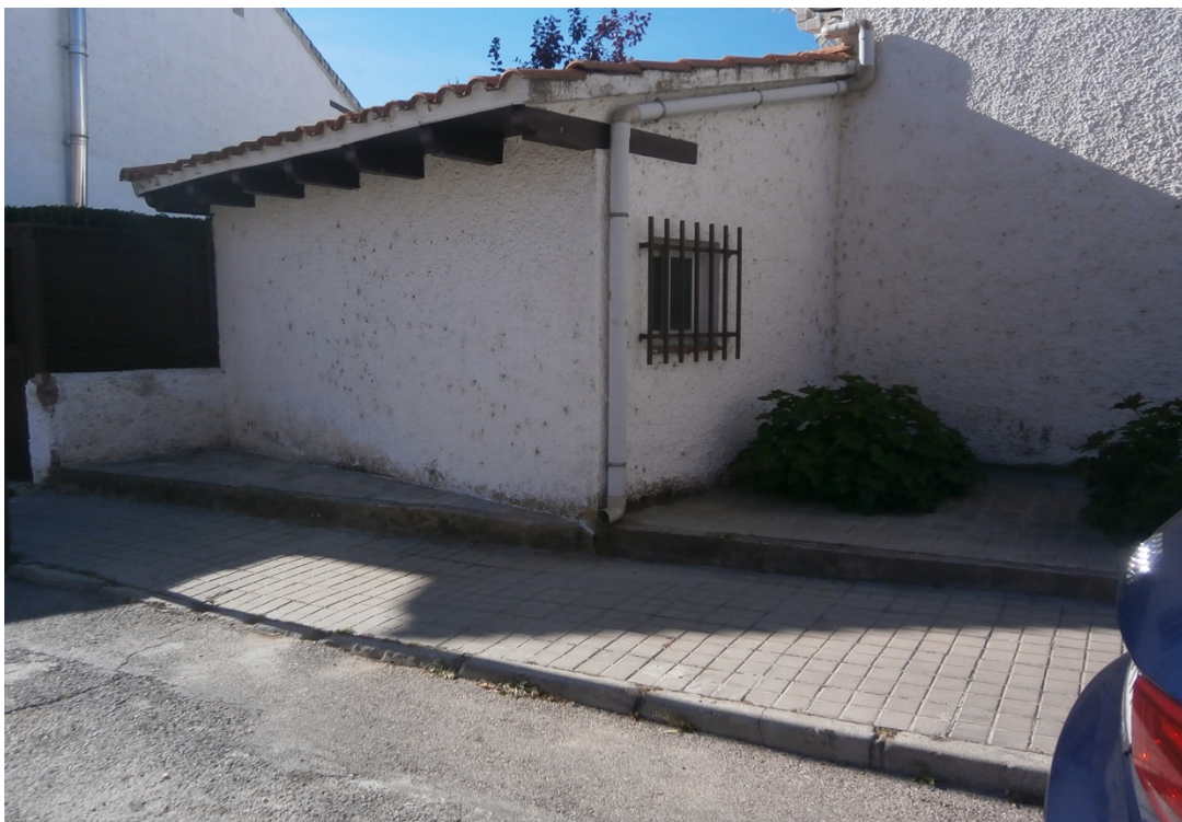
FOTO N° 6. Rotura de bordillo. (MD-Fase 2).
