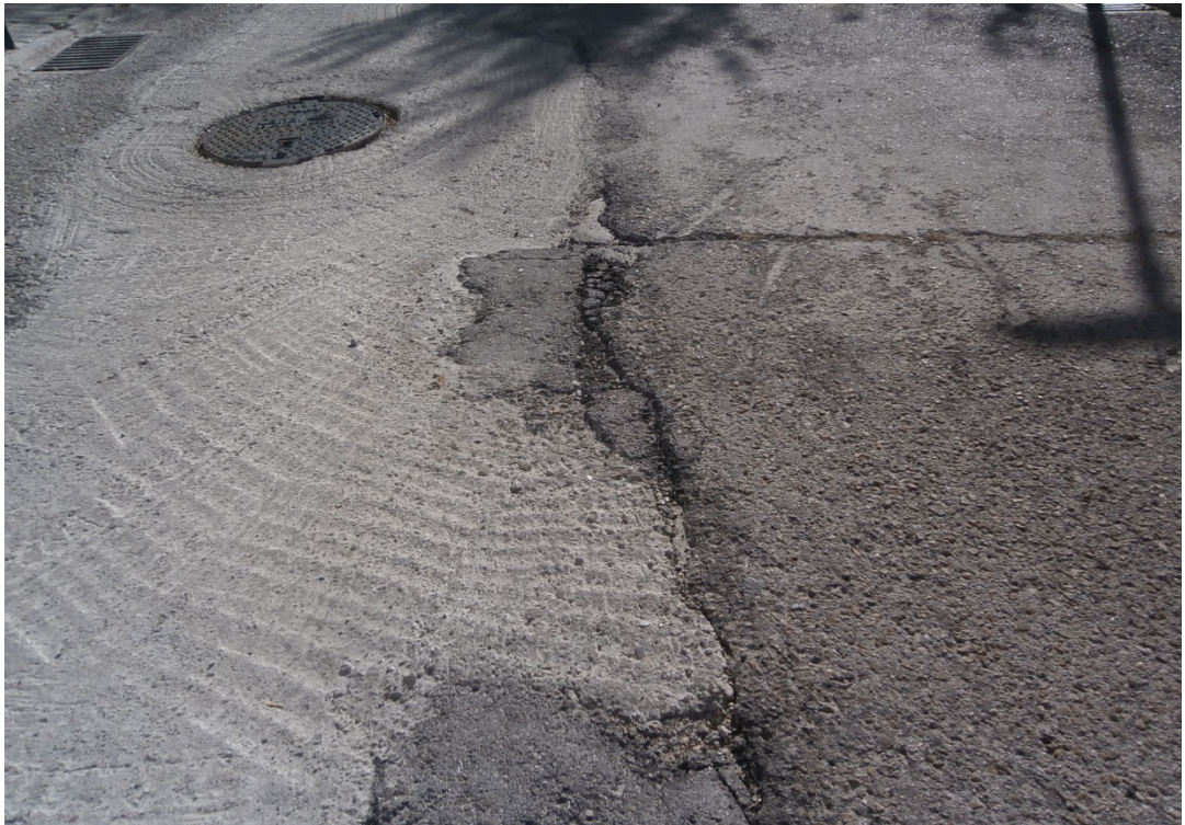
FOTO Nº 10. Fisuras longitudinales y transversales en firme. Nivelación inadecuada de calzada.
