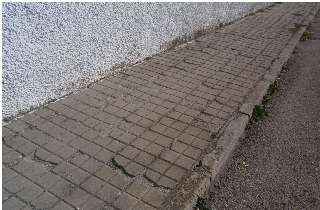
FOTO N° 1. Acera y bordillo con roturas. (MI-Fase 1)
