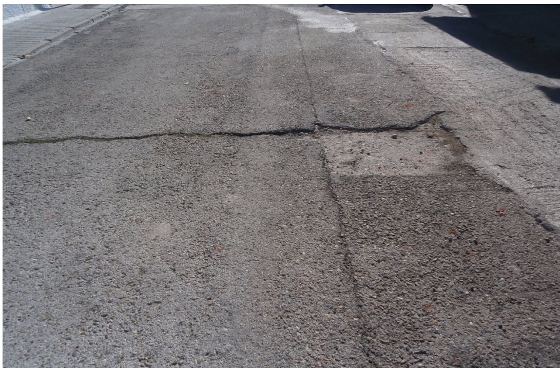
FOTO N° 4. Bache, fisuras longitudinales y transversales en firme. Parcheado longitudinal y transversal de hormigón (renovación de la red de abastecimiento a lo largo de toda la calzada en margen derecha).
