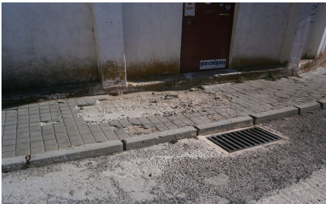
FOTO N° 5. Rotura de acera. (MI-Fase 3).
