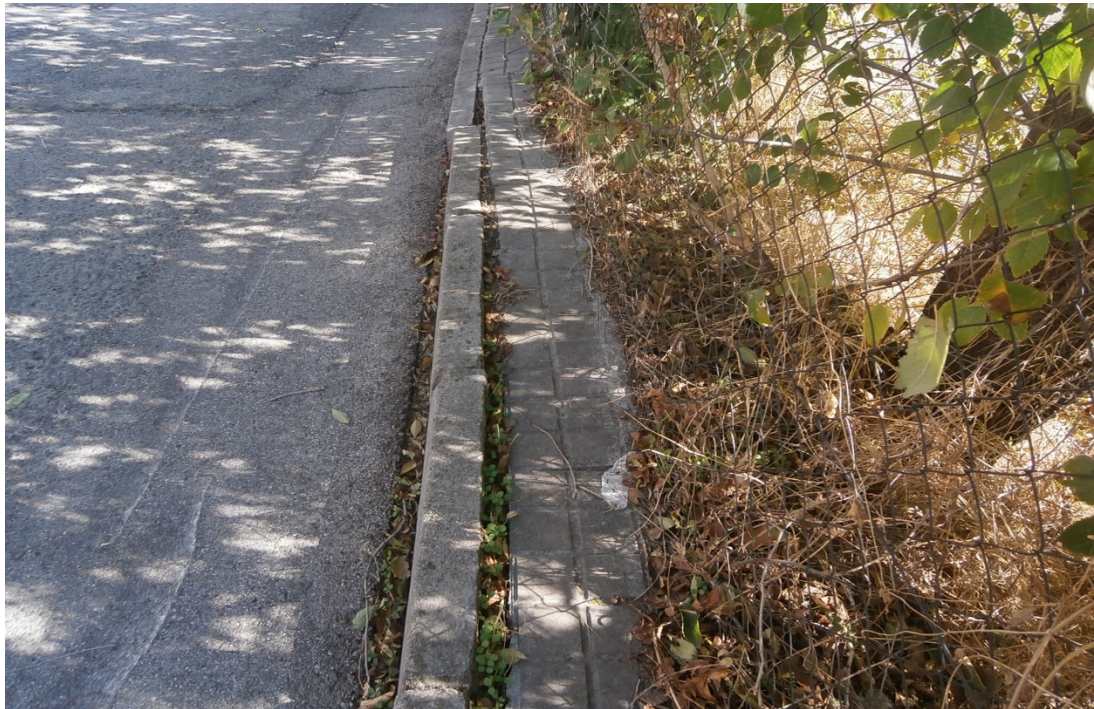
FOTO Nº 8. Hundimiento de acera. (MI-Fase 1).
