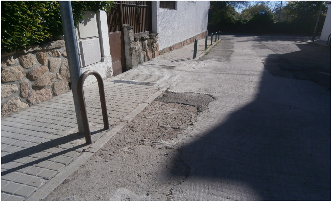
FOTO Nº 9. Descarnaduras en firme.
