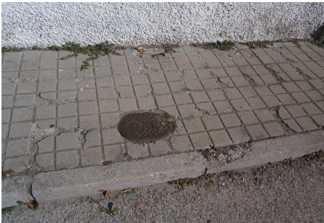
FOTO Nº 3. Acera y bordillo con roturas. Boca de riego. (MI-Fase 1).
