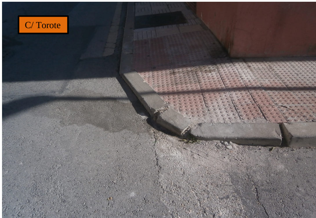
FOTO Nº 6. Acera de botones en rojo de paso de peatones deteriorada y bordillo con roturas. (MD-Fase 3).
