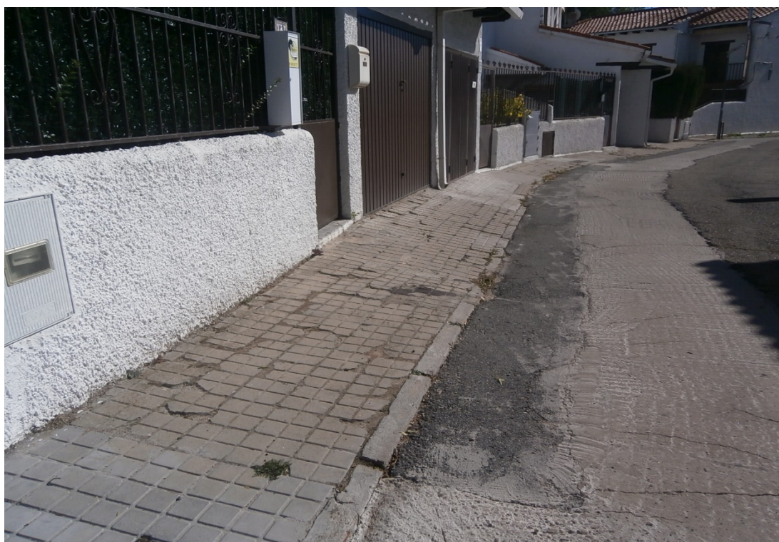
FOTO Nº 6. Acera y bordillo con roturas. (MI-Fase 1).
