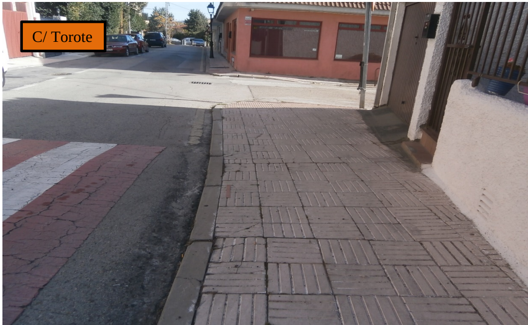
FOTO Nº 5. Rotura de acera. (MD-Fase 2).
