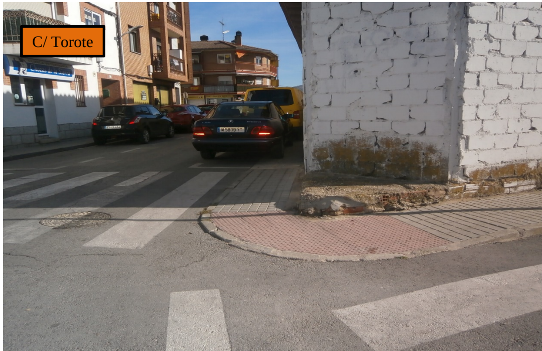
FOTO Nº 3. Acera de botones en rojo de paso de peatones deteriorada y bordillo con roturas. (MD-Fase 2).
