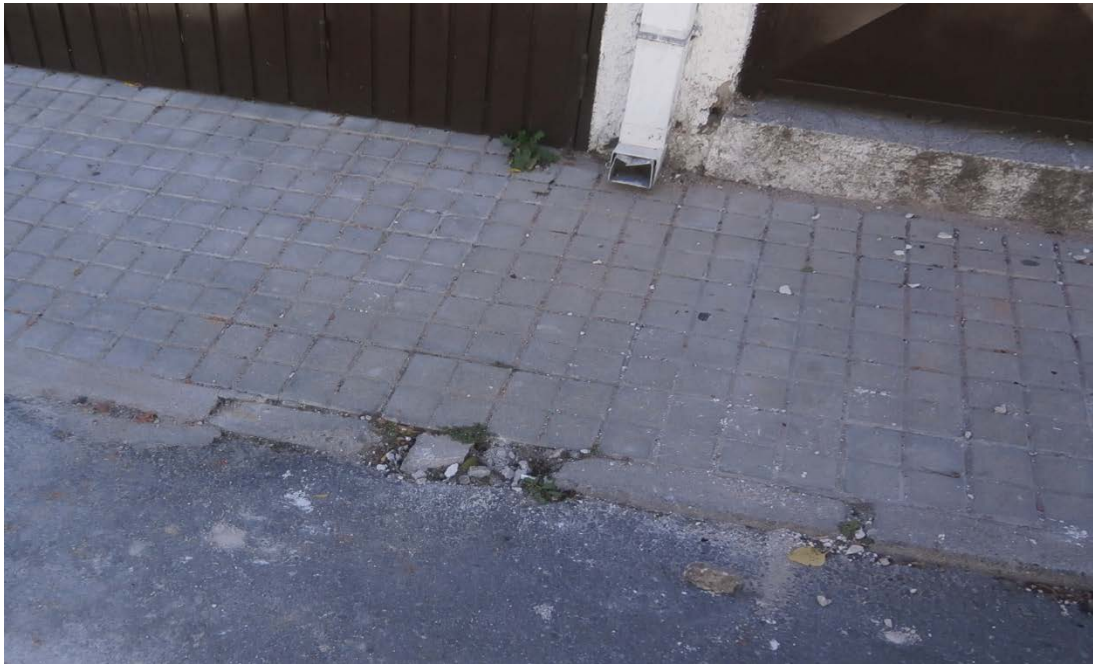
FOTO Nº 5. Rotura de bordillo. (MD-Fase1).
