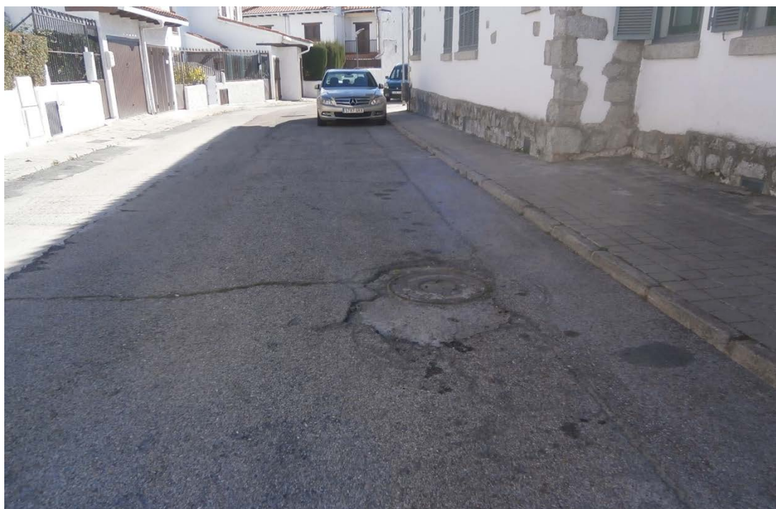
FOTO Nº 5. Bache, fisuras longitudinales y transversales en firme.
