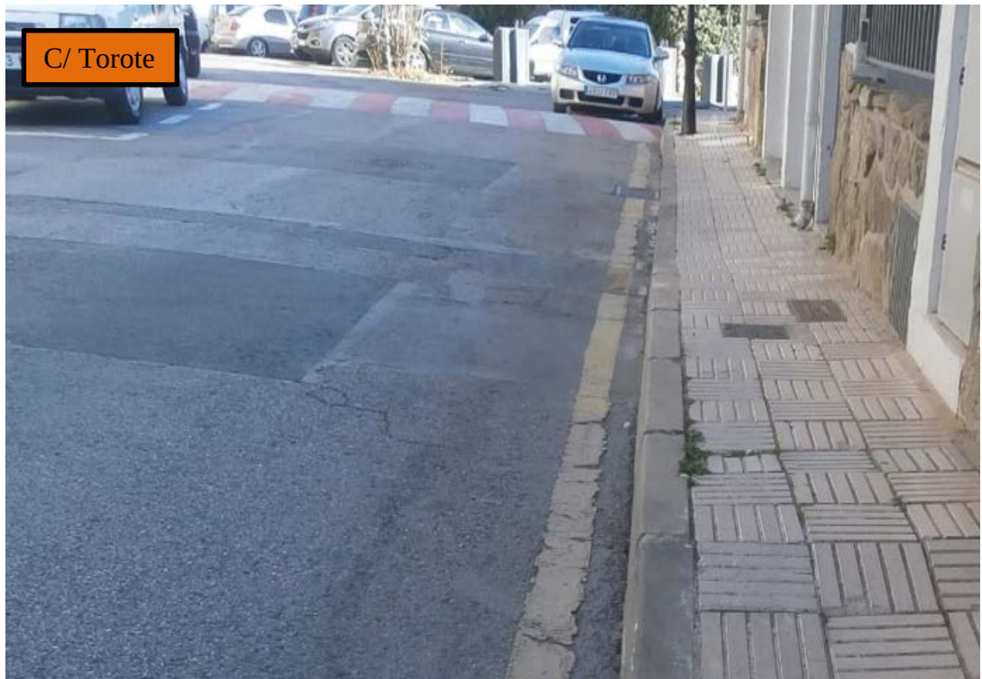
FOTO N° 8. Rotura y hundimiento de acera. (MD-Fase 3).
