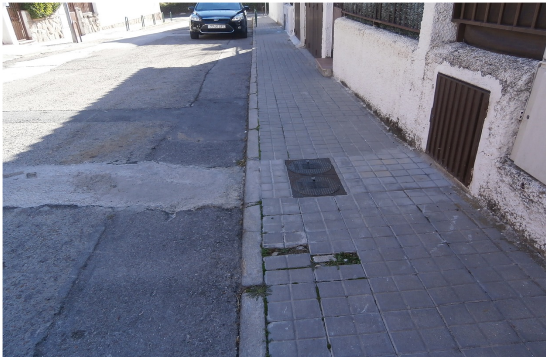
FOTO Nº 8. Acera con roturas. (MD-Fase 2).
