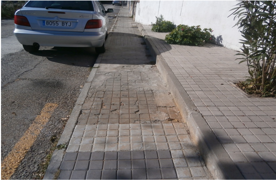
FOTO N° 1. Acera con roturas. (MD-Fase 3).
