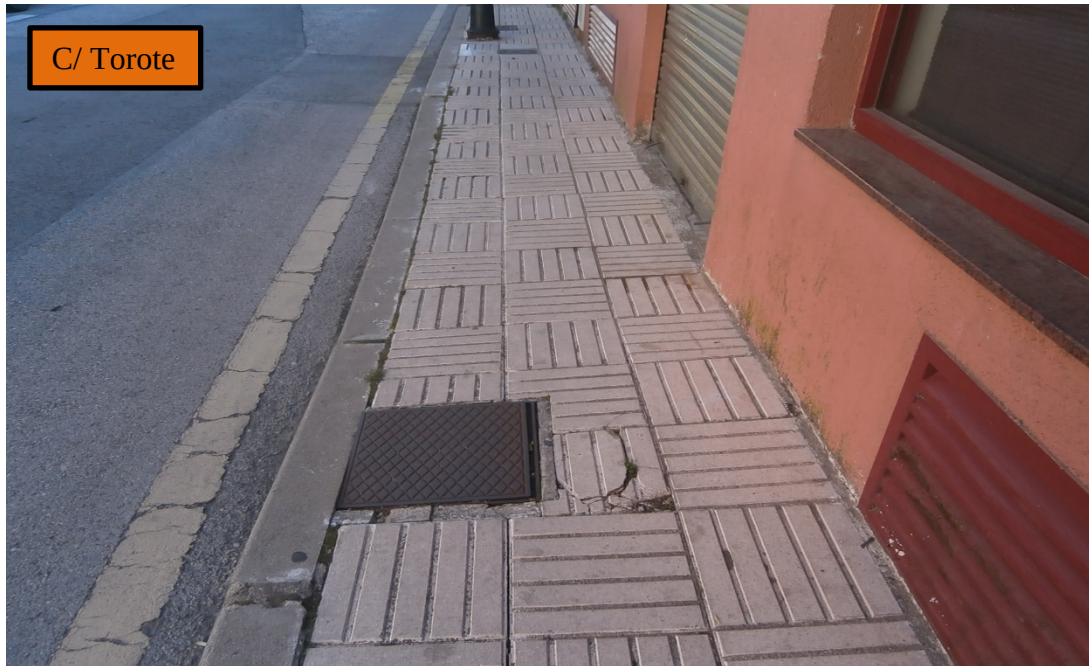
FOTO N° 7. Rotura de acera. (MD-Fase 3).
