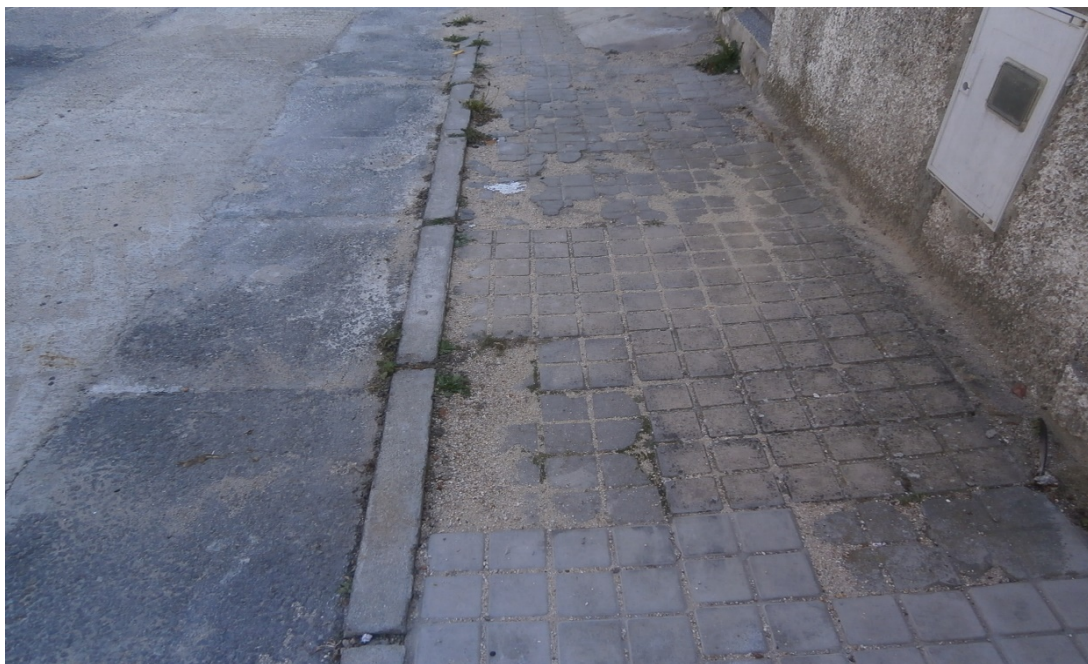
FOTO N° 9. Acera con roturas. (MD-Fase 1).
