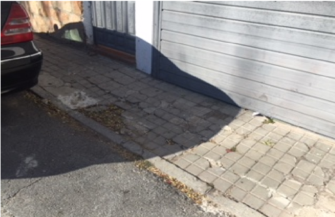
FOTO N° 2. Acera y bordillo con roturas en acceso a garaje. (MD-Fase 3).
