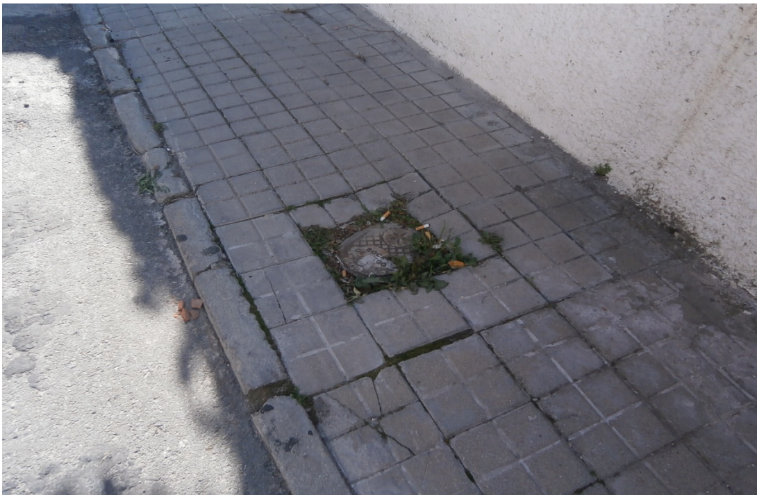
FOTO Nº 2. Acera y bordillo con roturas. Boca de riego con acera hundida. (MD-Fase 1).
