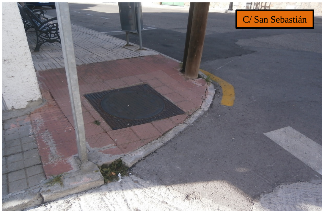
FOTO Nº 2. Acera de botones en rojo de paso de peatones deteriorada y bordillo con roturas. (MD-Fase 1).
