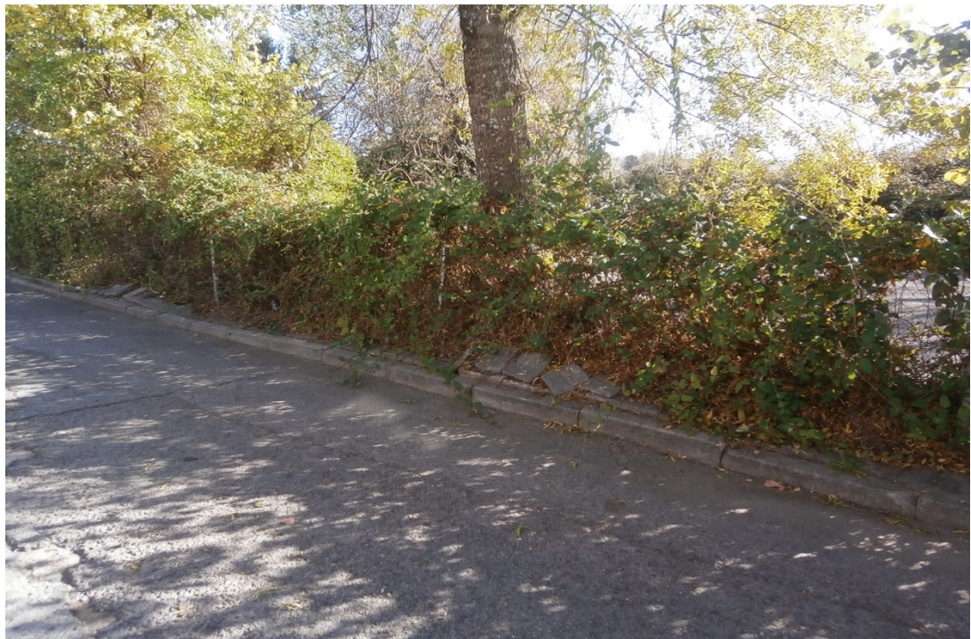
FOTO N° 4. Acera y bordillo con roturas. (MI-Fase 2).
