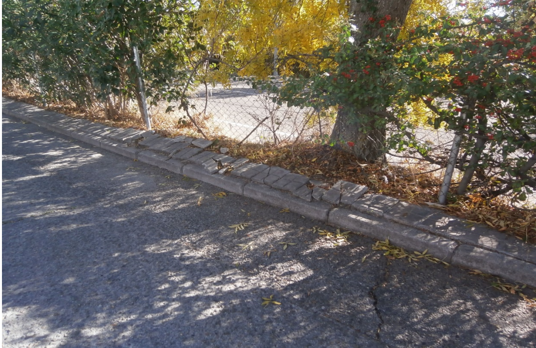
FOTO Nº 7. Acera con roturas. Fisuras en firme. (MI-Fase 2).
