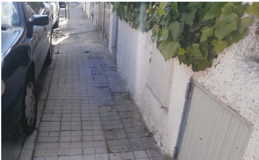
FOTO N° 3. Acera con roturas. (MD-Fase 1)
