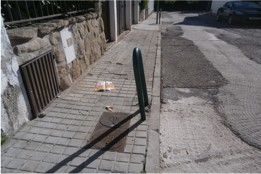
FOTO Nº 7. Acera con roturas. (MI-Fase 3).
