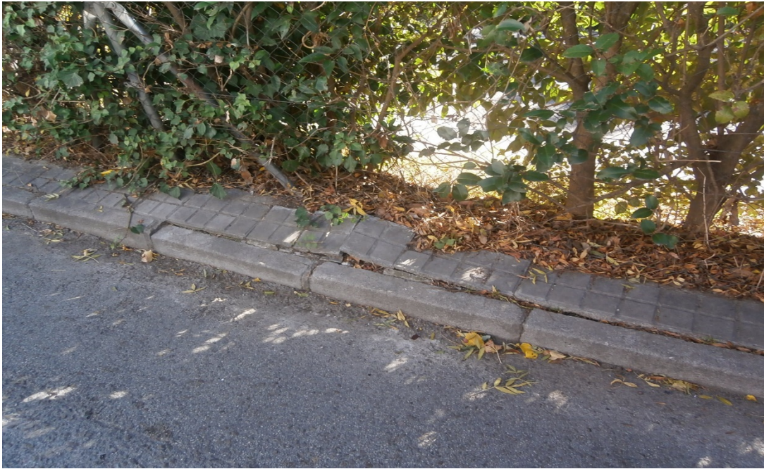
FOTO N° 5. Rotura de acera. (MI-Fase 2).
