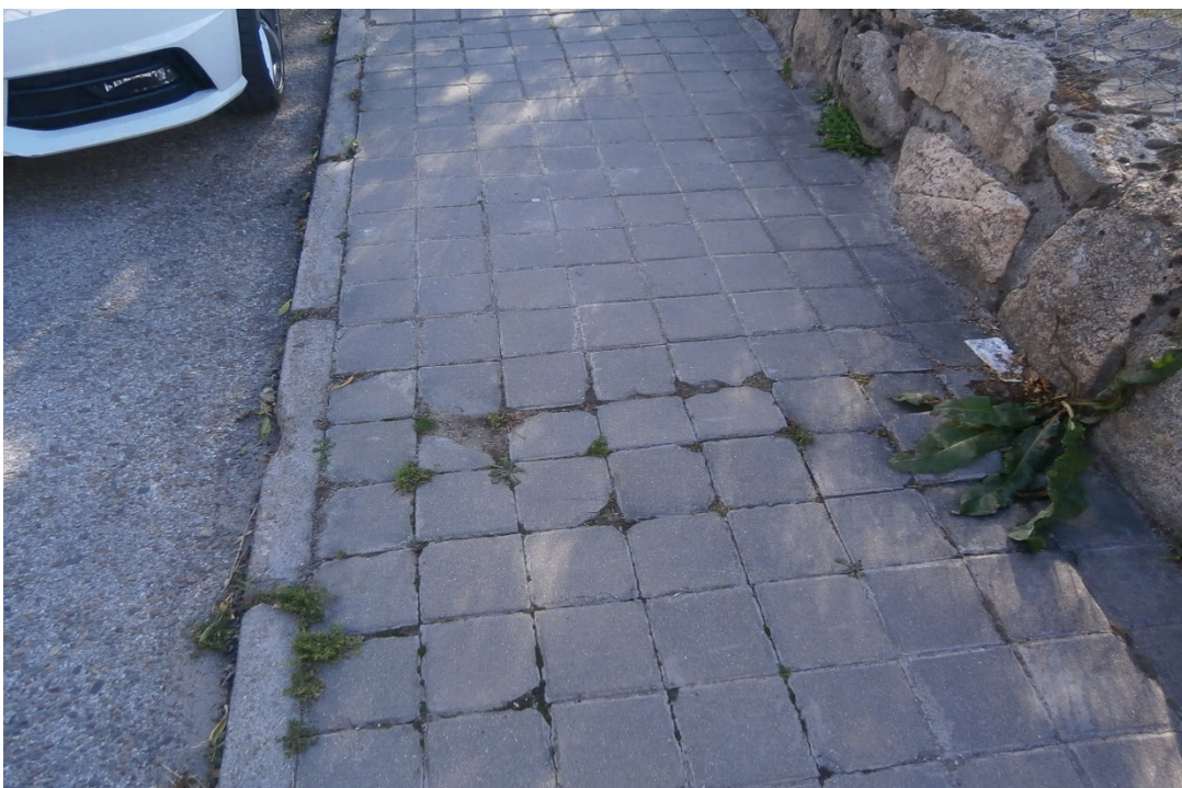
FOTO N° 8. Acera y bordillo con roturas. (MD-Fase 0).
