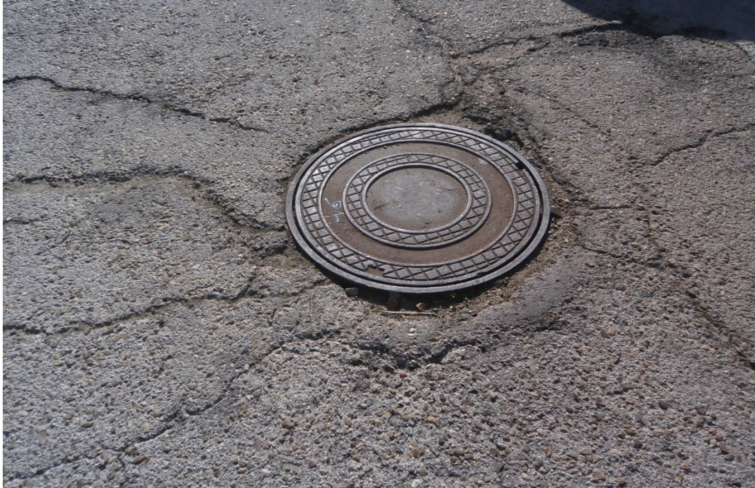
FOTO N° 7. Arqueta de saneamiento. Fisuras en firme.
