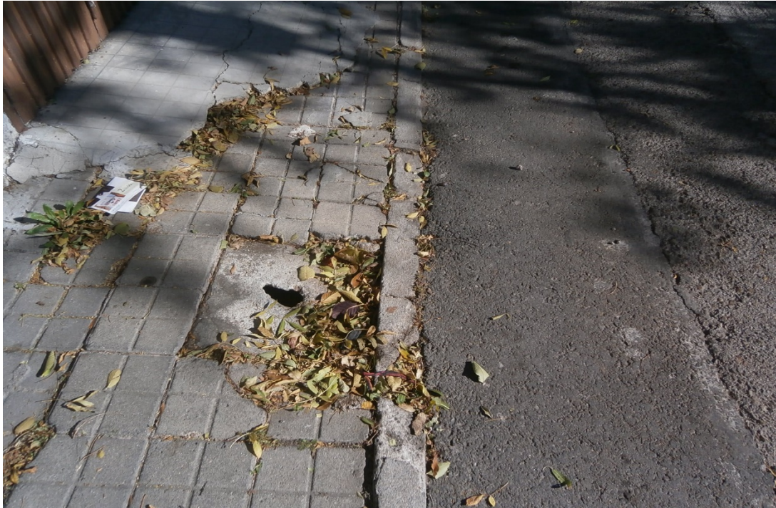
FOTO N° 9. Arqueta rota. (MD-Fase 1).
