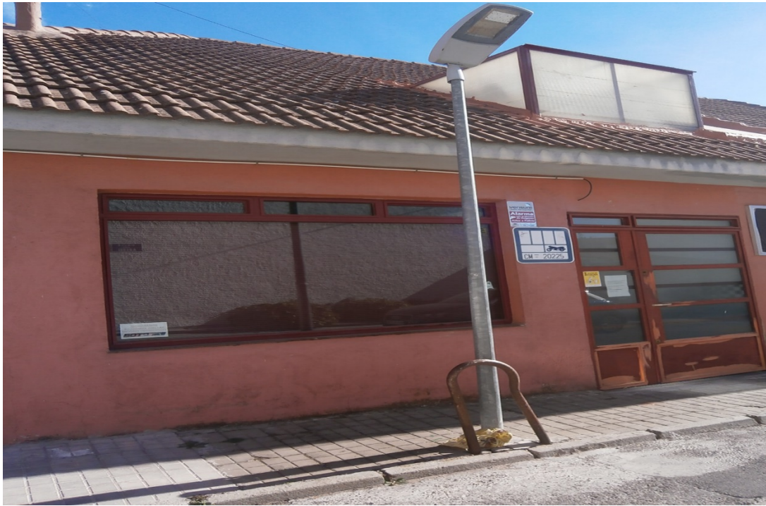
FOTO Nº 1. Farola con bolardo deteriorado. (MI-Fase 3).
