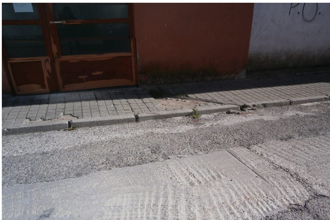
FOTO N° 4. Acera y bordillo con roturas. Bajante bajo acera. (MI-Fase 3).
