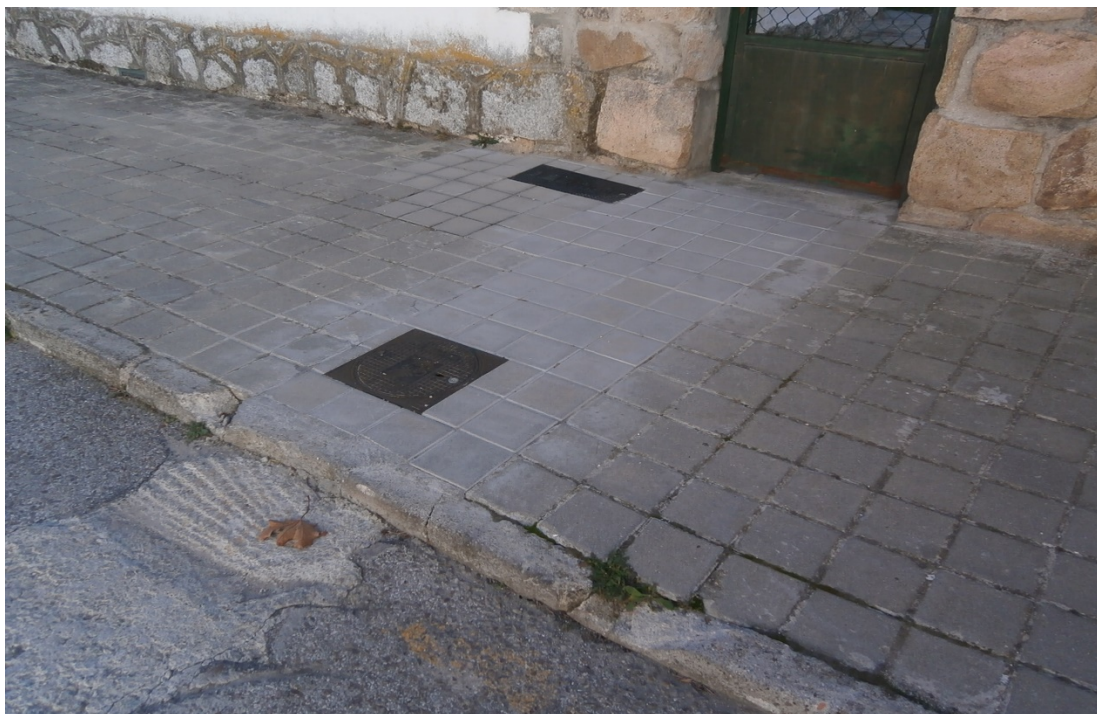
FOTO Nº 4. Acera en buen estado. Rotura de bordillo. (MD-Fase 0)
