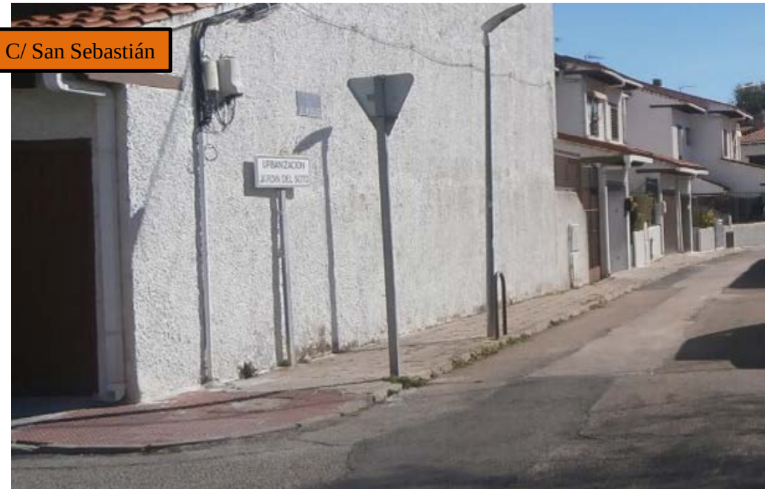
FOTO Nº 1. Acera de botones en rojo de paso de peatones deteriorada y bordillo con roturas. (MD-Fase 1).
