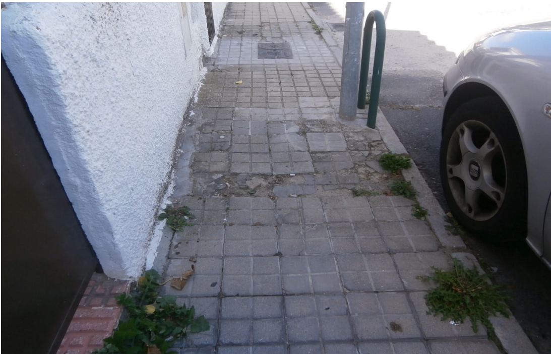
FOTO N° 8. Acera con roturas. (MD-Fase 1).
