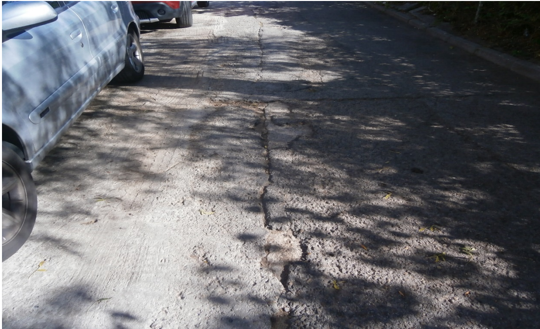
FOTO N° 3. Baches, fisuras longitudinales y transversales y parcheado longitudinal y transversal de hormigón (renovación de la red de abastecimiento a lo largo de toda la calzada en margen derecha).
