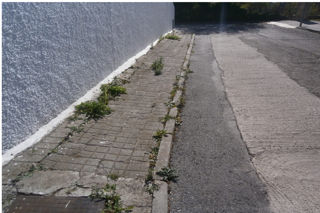
FOTO N° 9. Acera y bordillo con roturas. (MI-Fase 1).
