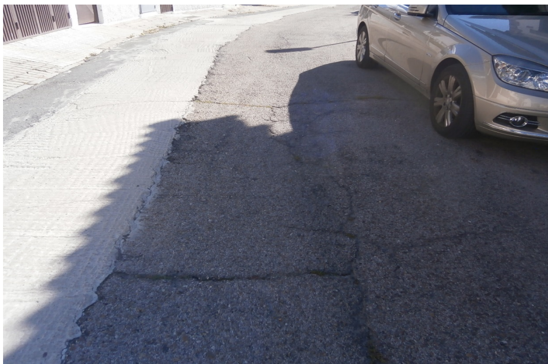
FOTO N° 7. Hundimiento, fisuras longitudinales y transversales en firme.
