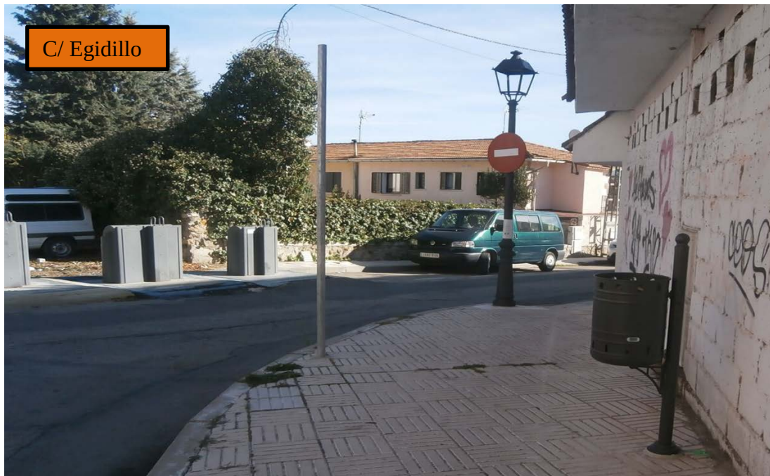
FOTO N° 9. Rotura de acera. (MD-Fase 3).
