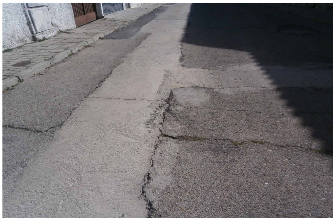
FOTO N° 2. Parcheado longitudinal y transversal de hormigón (renovación de la red de abastecimiento a lo largo de toda la calzada en margen izquierda), descarnaduras y fisuras transversales continuas en firme.
