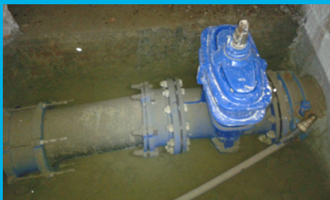
Fugas no localizadas
