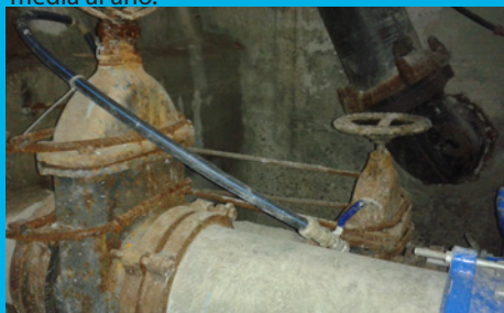
Rotura de tuberías: más de 100 averías de media al año.
