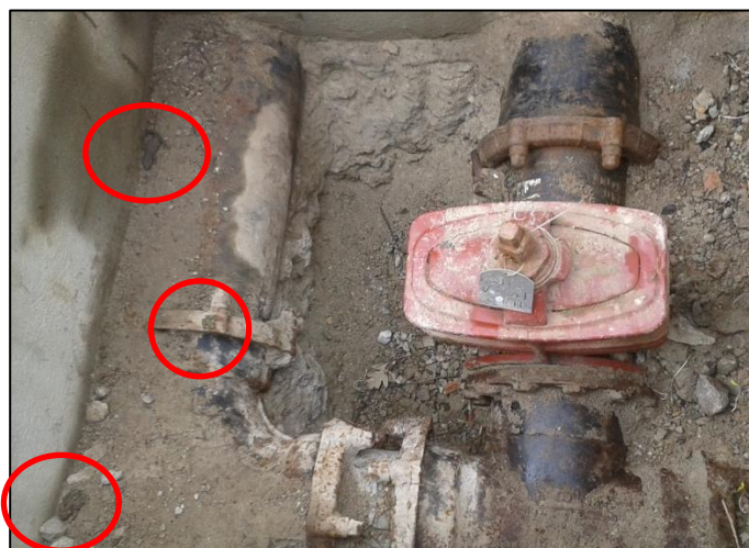
FOTOGRAFÍA 10. DETALLE Y DEMOSTRACIÓN DE INTRUSIÓN DE SERES VIVOS (SALAMANDRA, SAPO Y RANA) EN ARQUETAS. ESTA ARQUETA PERTENECE AL DEPÓSITO DE LA HIRUELA.
