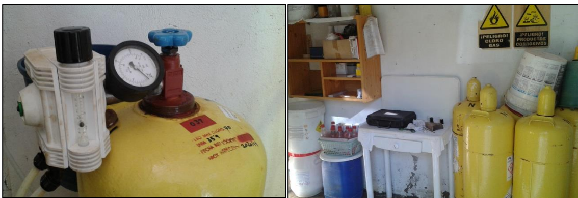
FOTOGRAFÍA 8. SALA DE DOSIFICACIÓN DE CLORO GAS.
