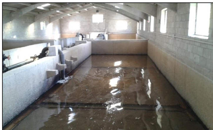
ILUSTRACIÓN 2. FILTROS E.T.A.P. ESTIVAL. ES PROBABLE QUE LOS MUROS DE LOS FILTROS NO SOPORTEN UNA DOSIFICACIÓN DE REACTIVOS MÁS AGRESIVOS
