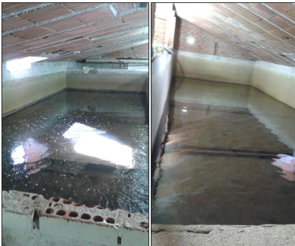
FOTOGRAFÍA 4. FILTROS DE LA E.T.A.P. INVERNAL. LA ALTURA DEL TECHO ES INSUFICIENTE PARA LAS TAREAS DE LAVADO MANUAL. LA GRANULOMETRÍA ES INADECUADA. EXISTEN FUGAS IMPORTANTES. EL REPARTO DE AGUA A LOS FILTROS NO ES HOMOGÉNEO.
