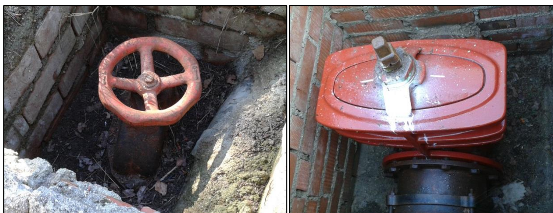
FOTOGRAFÍA 2. DETALLE DE VÁLVULAS OXIDADAS. VÁLVULAS QUE REGULAN LA ENTRADA A LA E.T.A.P. INVERNAL.
