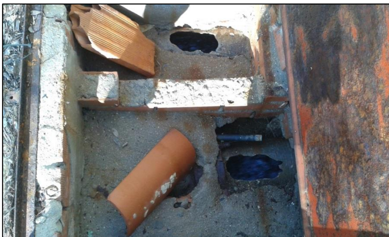
ILUSTRACIÓN 3. TUBERÍAS DE SALIDA DE AGUA A DEPÓSITOS (HIRUELA, SOTOSIERRA, ETC.) ROTAS.
