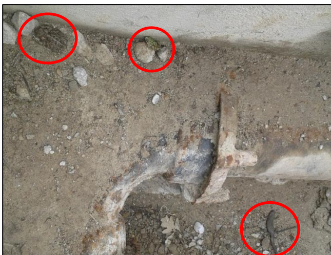
FOTOGRAFÍA 11. DETALLE Y DEMOSTRACIÓN DE INTRUSIÓN DE SERES VIVOS (SALAMANDRA, SAPO Y RANA) EN ARQUETAS. ESTA ARQUETA PERTENECE AL DEPÓSITO DE LA HIRUELA.
