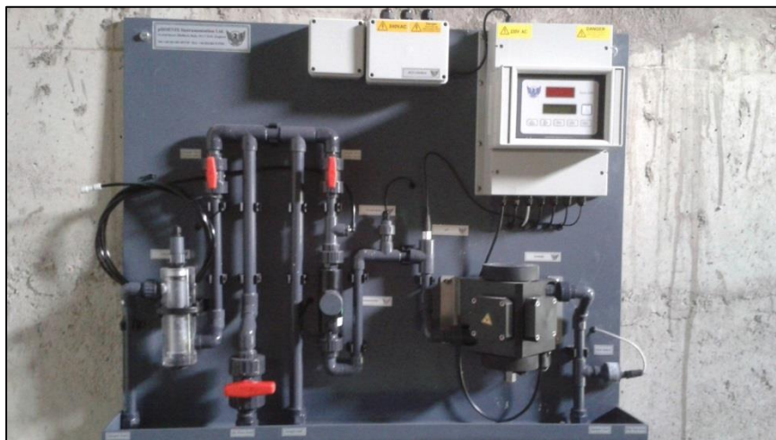
FOTOGRAFÍA 19. EJEMPLO DE ESTACIÓN DE CALIDAD INSTALADA EN DEPÓSITO DE LA HIRUELA. MEDIRÁ LOS PARÁMETROS TEMPERATURA, pH, CLORO, TURBIDEZ Y CONDUCTIVIDAD.
