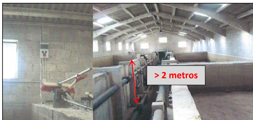
FOTOGRAFÍA 16. PASOS NO NORMALIZADOS Y FALTA DE BARANDILLAS. RIESGO DE CAÍDA A DISTINTO NIVEL DE MÁS DE 2 METROS.
