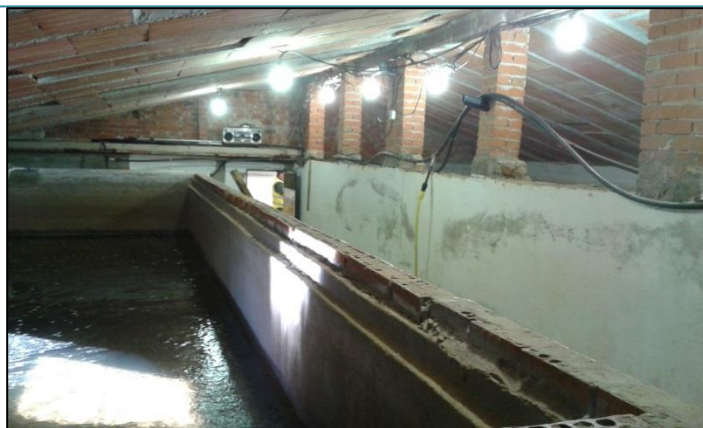
FOTOGRAFÍA 13. CABLEADO EN LA E.T.A.P. INVERNAL. TENDIDOS AL AIRE Y GRAPADO EN PARED SIN CANAL, BANDEJA O TUBOS. ILUMINACIÓN SIN LUMINARIAS.
