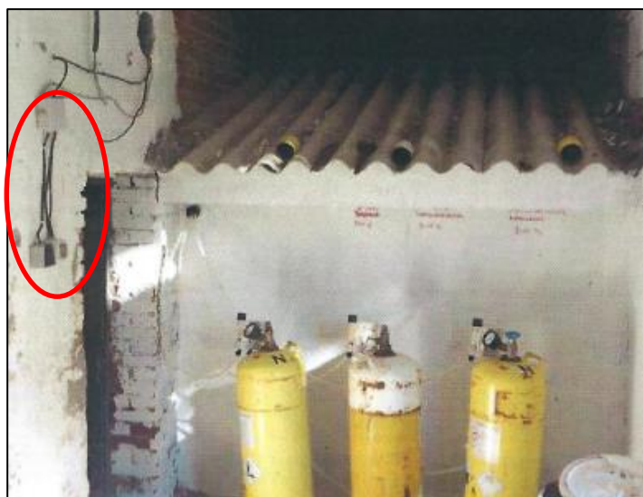
FOTOGRAFÍA 14. ZONA DE DOSIFICACIÓN DE CLORO GAS JUNTO A INSTALACIÓN ELÉCTRICA SIN PROTECCIÓN ANTE ATMÓSFERAS EXPLOSIVAS (NORMATIVA ATEX).
