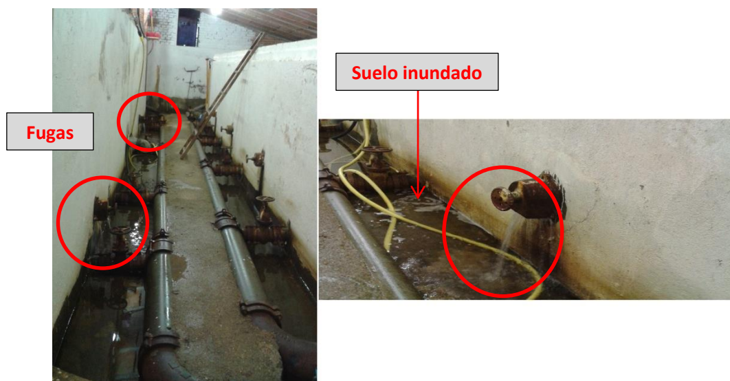
FOTOGRAFÍA 5. PASILLO DE ACCESO A FILTROS DE LA E.T.A.P. INVERNAL. CONDUCCIONES DE RECOGIDA DE AGUA FILTRADA. NUMEROSAS FUGAS.
