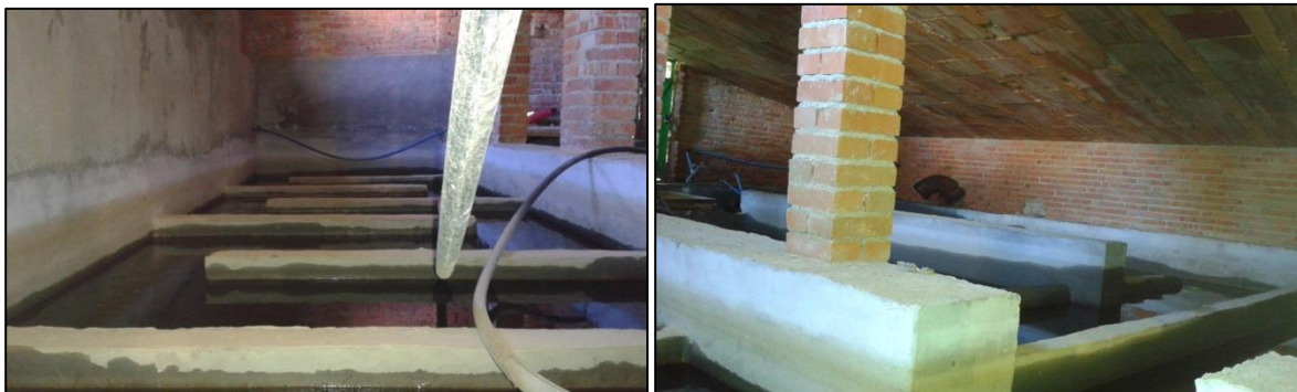
FOTOGRAFÍA 3. LABERINTO DE DECANTACIÓN DE LA E.T.A.P. INVERNAL.
