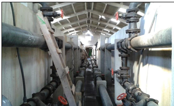
FOTOGRAFÍA 6. PASILLO DE ACCESO A FILTROS DE LA E.T.A.P. ESTIVAL. CONDUCCIONES DE REPARTO A FILTROS Y RECEPCIÓN DE AGUA FILTRADA.
