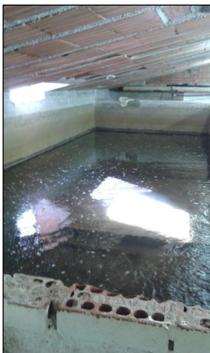
FOTOGRAFÍA 17. FILTRO E.T.A.P. INVERNAL. SIN BARANDILLAS DE SEGURIDAD. DIMENSIONES INAPROPIADAS.
