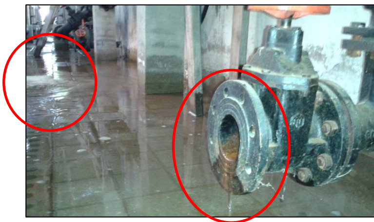
FOTOGRAFÍA 7. DETALLE DE VÁLVULA CON FUGA Y SURGENCIAS DE AGUA EN EL SUELO DEL PASILLO DE LA E.T.A.P. ESTIVAL.
